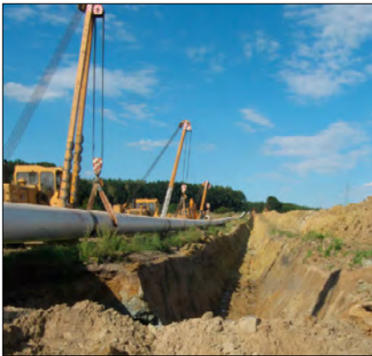
Fot. 1. Montaż rury gazociągu metodą wykopową Pic.1. Installation of the gas pipeline with the excavation technique
