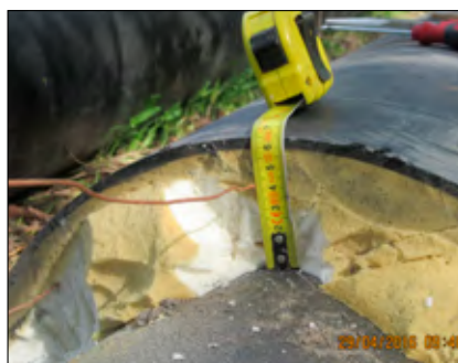
Fot.1 Położenie drutu alarmowego, norma mówi o 15 mm
